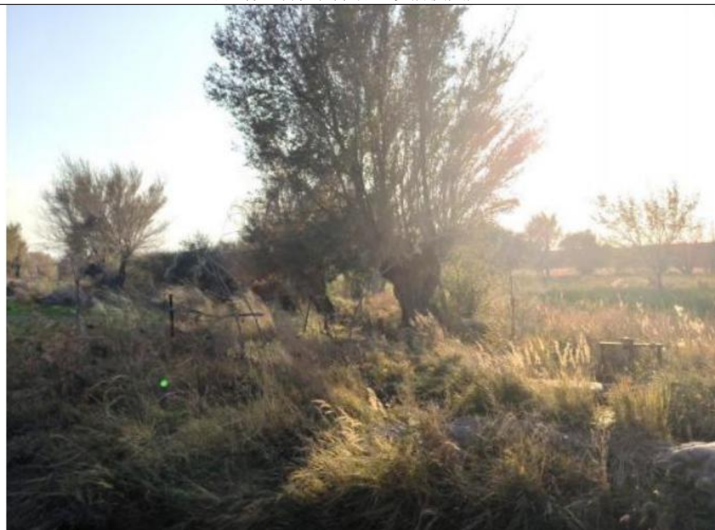
东沟乡建筑物配套不完善，渠道过流断面被树木、杂草束窄，过流无法满足要求
