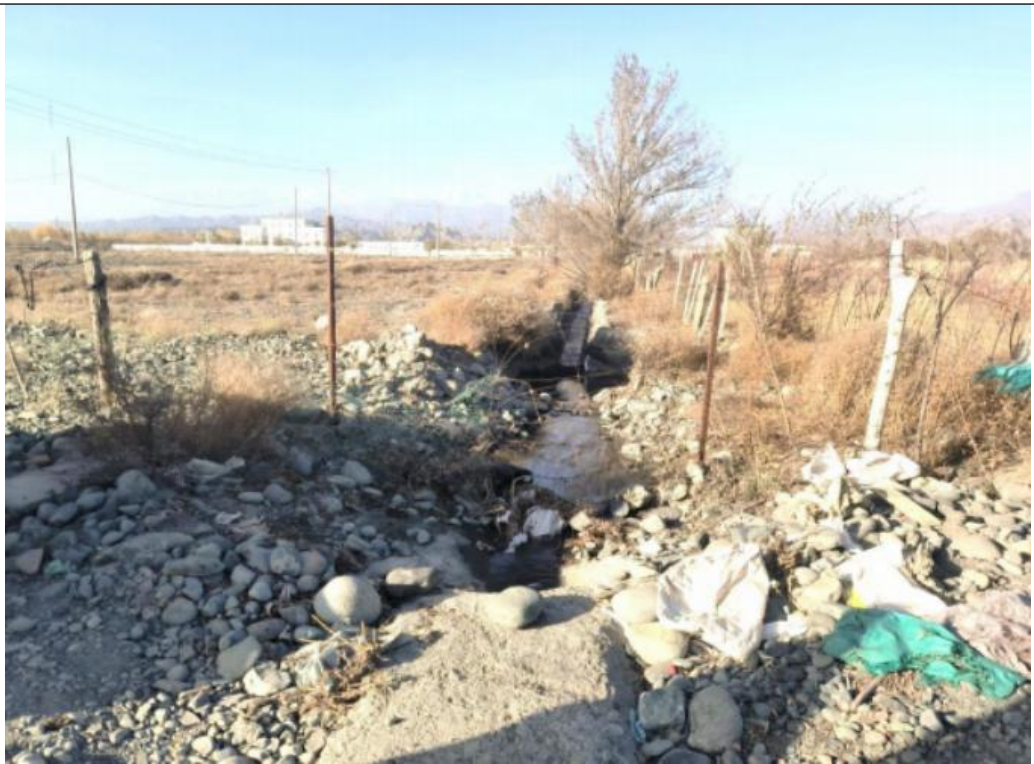
阿克苏支渠建筑物配套不完善，渠道被填埋
