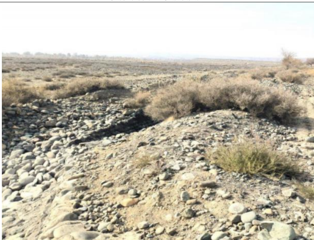
沙梁子六队分支渠未衬砌，渗漏损失严重
