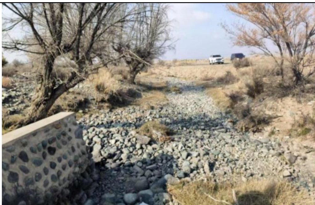
西支渠末衬砌，渗漏损失严重
