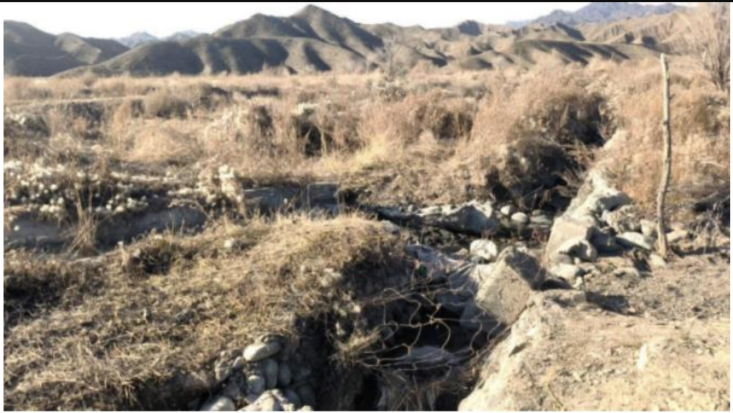
阿克苏斗渠建筑物配套不完善，渠道过流断面被杂草束窄，衬砌材料脱落、塌陷
