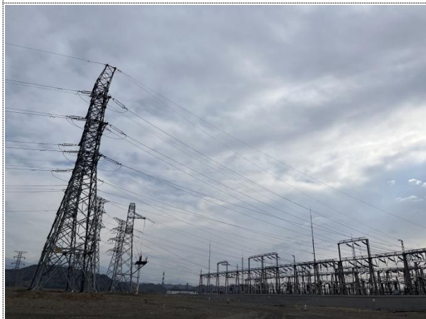
祁家沟 220kV 变电站
