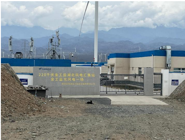
本项目接入 220 千伏金工盐湖北风电汇集站
