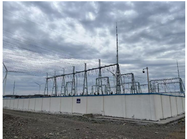
本项目线路接入间隔
