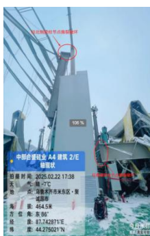
图 3 梁柱节点破坏形式
