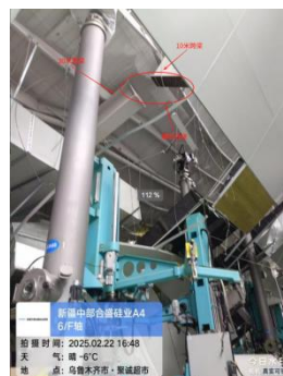
图 4 6/E~F 梁拼接处螺栓脱开
